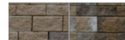
Kerítés hidrofobizált anyagból / Kerítés hidrofobizálás nélkül
