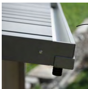
Elülső oldali beépített esőcsatorna.
